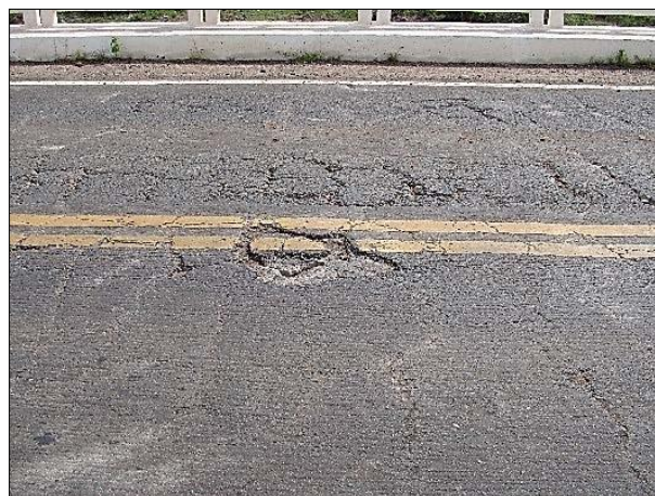
Figura 3.2 – Fissuras no pavimento betuminoso
