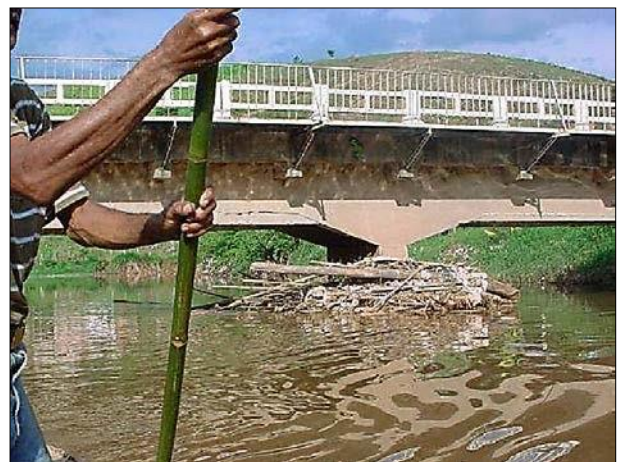
Fig. 3.2 – Troncos/galhos presos à estrutura
