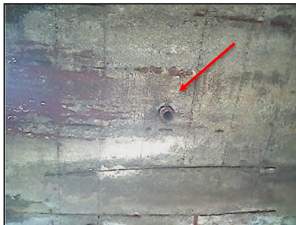
Fig. 3.2 – Dreno de diâmetro insuficiente
