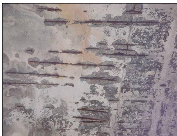
Figura 3.4 – Armaduras oxidadas (laje)
