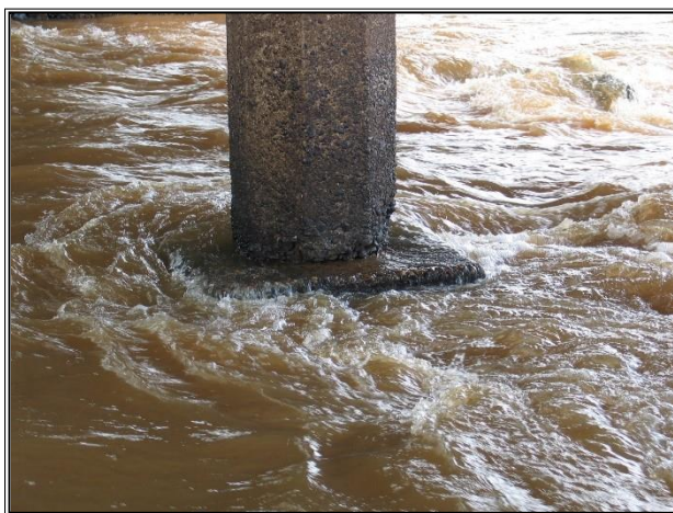
Figura 3.1 - Erosão no pilar e no bloco
