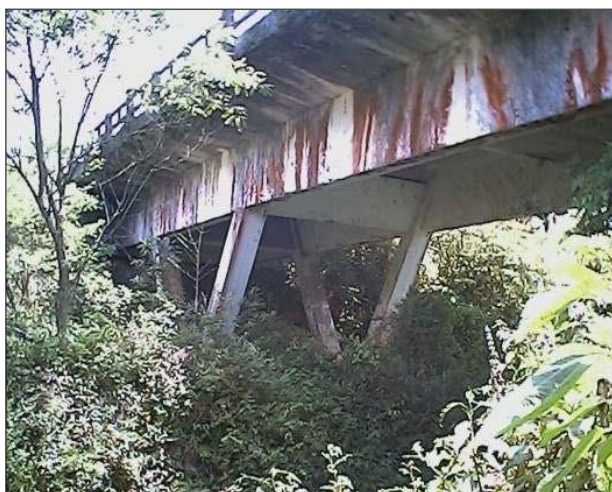
Figura 3.1 – Manchas de corrosão
