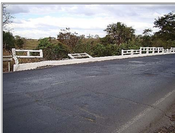
Fig. 3.1 - Guarda corpos destruídos
