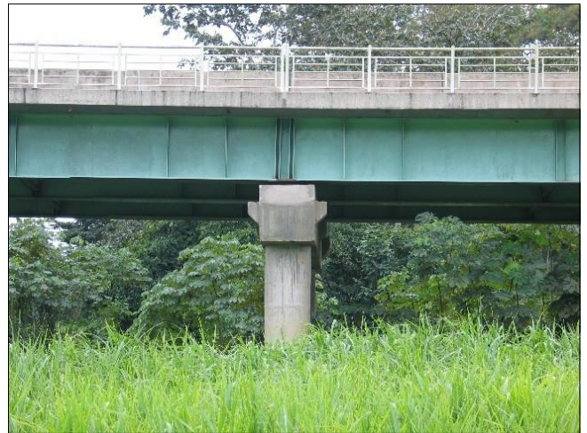
Fig. 3.2 – Capim sob a ponte e no seu entorno
