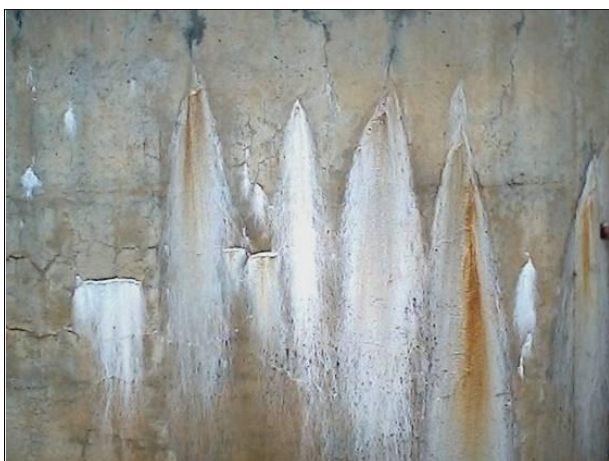
Figura 3.1 – Eflorescências em viga
