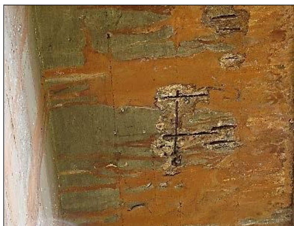
Fig. 3.2 – Armadura exposta e oxidada
