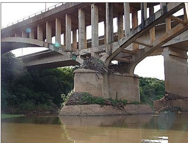
Fig. 3.1 – Galhos sobre bloco/pilar
