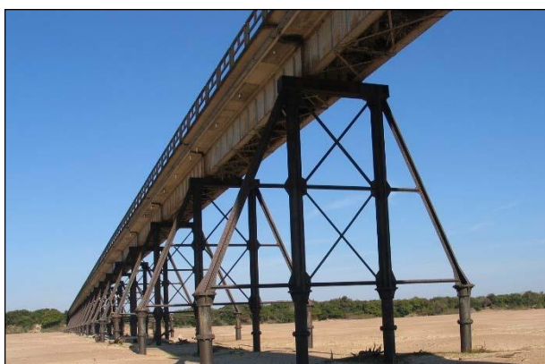
Figura 3.3 – Material acumulado na estrutura
