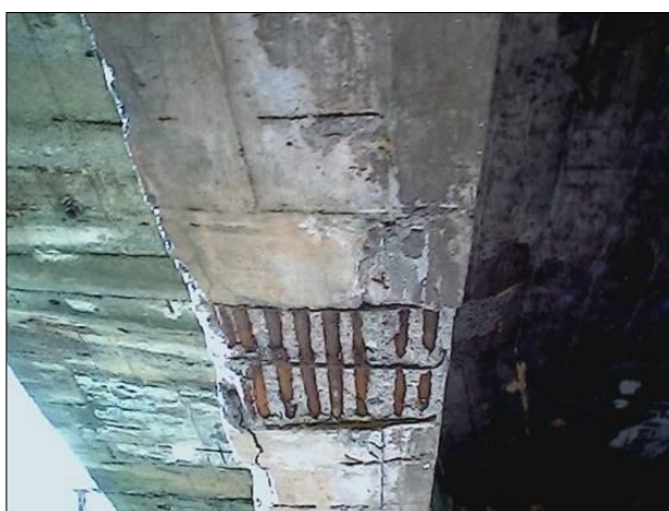
Figura 3.3 – Armaduras oxidadas (viga)
