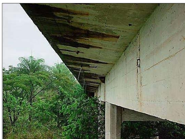
Fig. 3.1 – Manchas na laje
