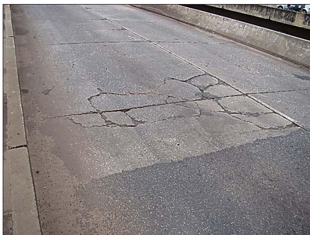
Figura 3.1 – Pavimento de concreto quebrado
