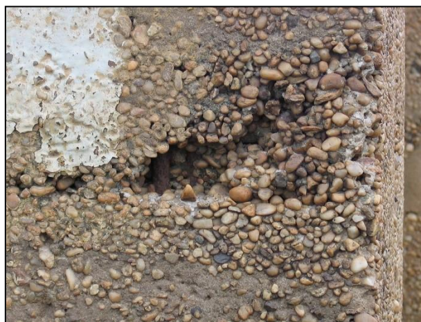
Figura 3.2 – Erosão no pilar
