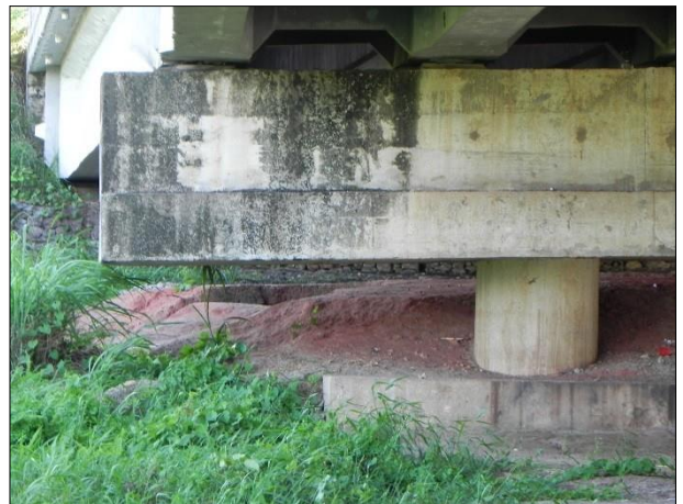
Figura 3.2 - Sujeira e manchas na travessa
