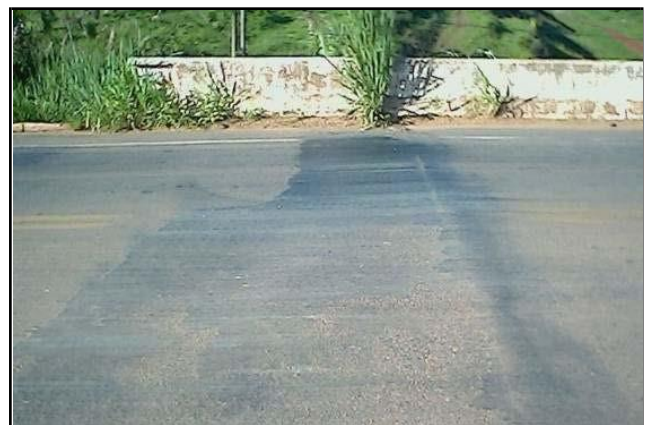
Figura 3.2 - Sujeira e vegetação junto à barreira
