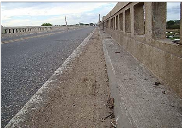
Figura 3.1 - Acúmulo de detritos
