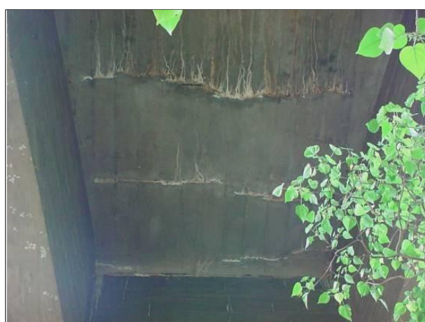
Figura 3.2 – Eflorescências em laje
